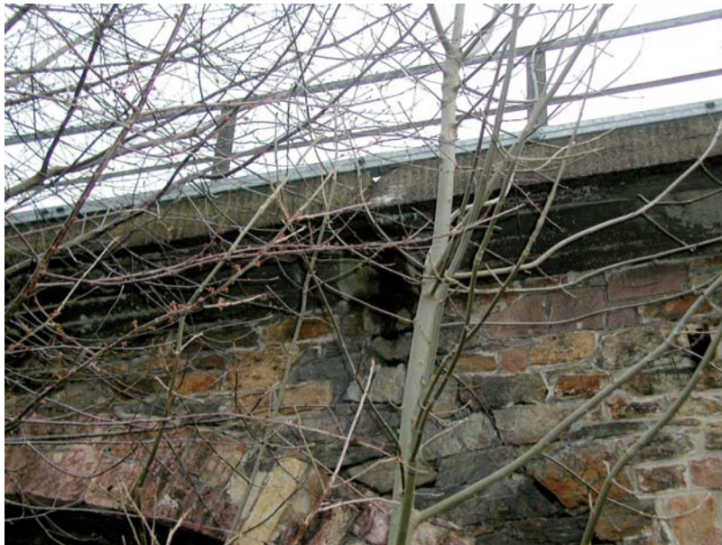
Bild 8: Typisches Rissbild in der Übermauerung
